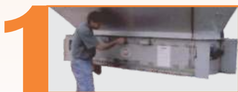
Acesso à grelha através da porta articulada.
